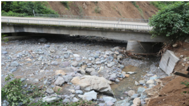
Şekil 7-8. Hopa-Artvin karayolu tesislerinde meydana gelen tahribatlar
