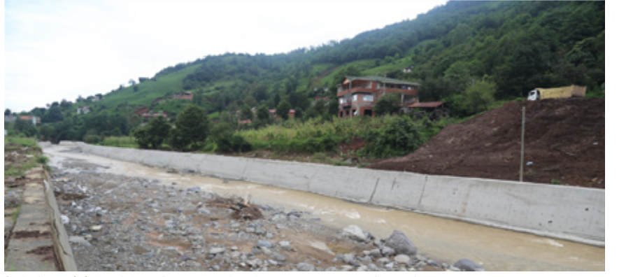
Şekil 13. Teknik açıdan yeterli olmayan istinat duvarları.
