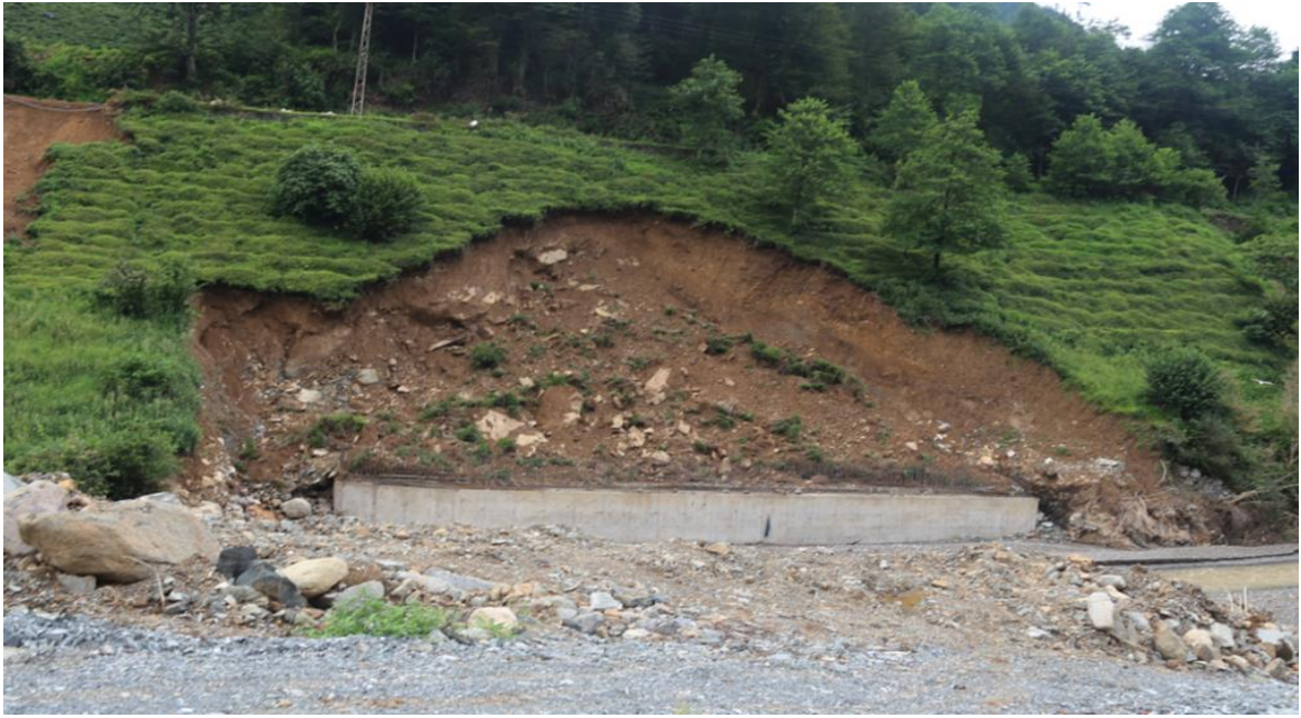
Foto-11- Teknik açıdan yeterli olmayan sanat yapılarının oluşturduğu tahribatlar
