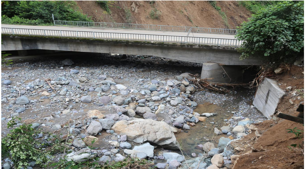
Foto-8: Hopa-Artvin karayolu tesislerinde meydana gelen tahribatlar
