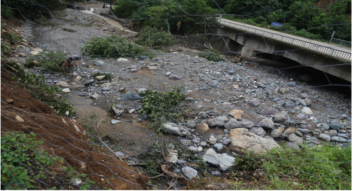
Foto-7: Hopa-Artvin karayolu tesislerinde meydana gelen tahribatlar
