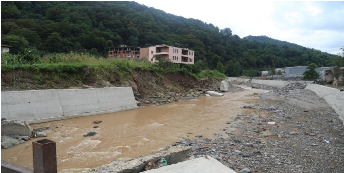
Foto-12: Teknik açıdan yeterli olmayan sanat yapılarının oluşturduğu tahribatlar.
