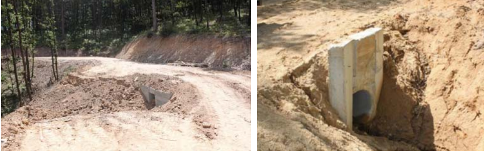
Şekil 6. Orman yollarında sanat yapılarının yapımındaki hatalar
