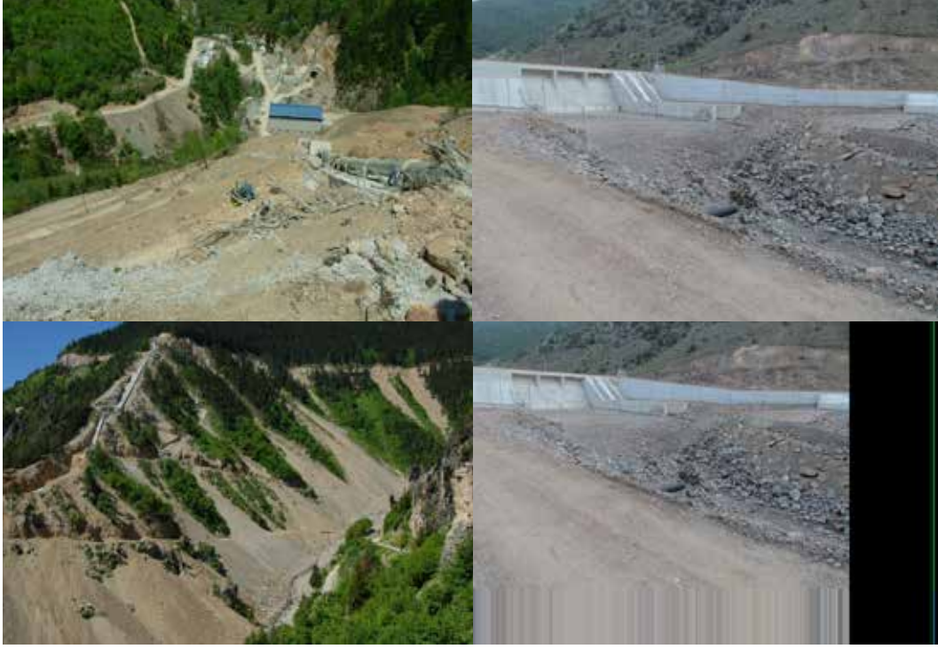
Şekil 4. Doğu Karadenizdeki çeşitli HES inşaatlarının oluşturduğu tahribat
